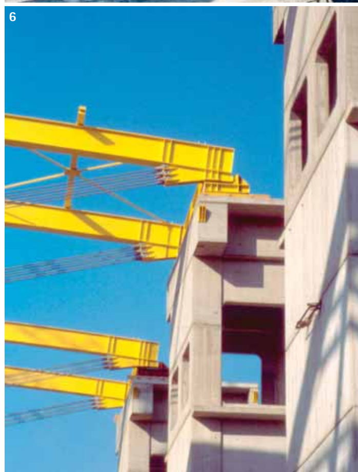
Fig. 5 - Trave armata di copertura durante il montaggio in cantiere. Fig. 6 - Dettaglio costruttivo di appoggio e ritegno orizzontale della struttura di copertura
