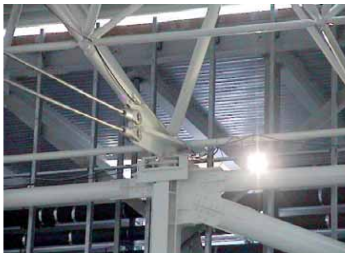
Fig. 20 - Vista interna del padiglione 15. Ancoraggio dei tiranti alla struttura spaziale in corrispondenza dell'appoggio mobile
