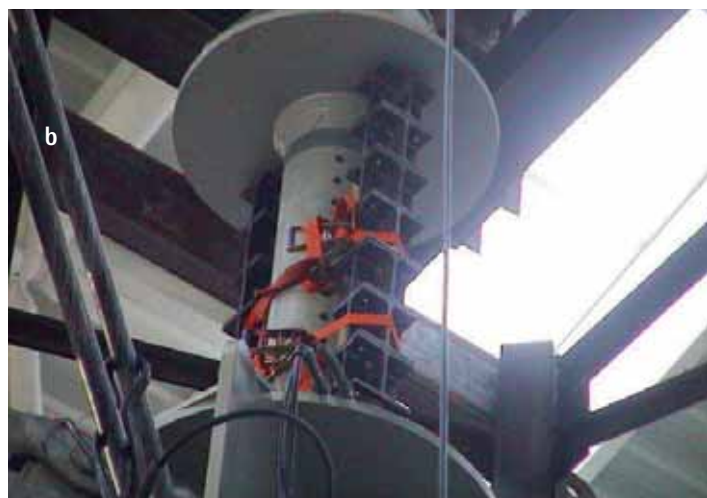
Fig. 18 - a) Nodo che collega il puntone alle funi e b) dettaglio del sistema di martinetti idraulici usato per sollevare la copertura dagli appoggi provvisori e pretensionare le funi
