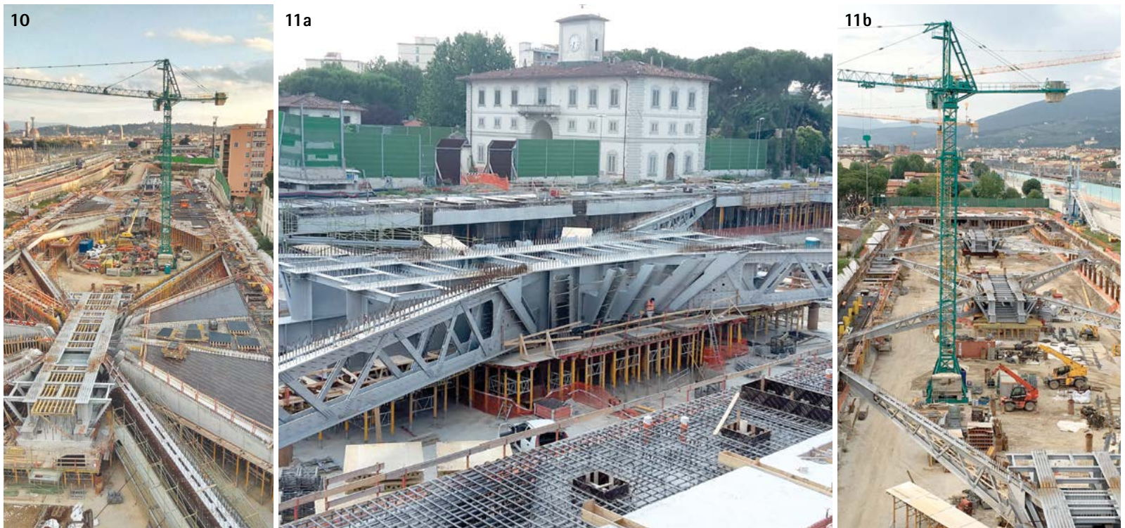
Fig. 10 - Vista aerea dell'area di cantiere durante la realizzazione delle strutture del piano primo; Fig. 11a - 11b - Realizzazione delle strutture metalliche del primo piano, le travi a ventaglio più lunghe sono realizzate in acciaio mentre quelle più corte in cemento armato
