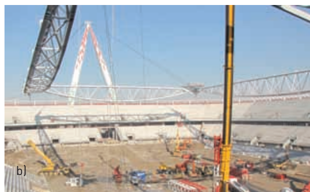
Figura 19 - a) Cavalletto ad A in posizione per il sollevamento e torre provvisoria, b) Sollevamento delle travi principali
