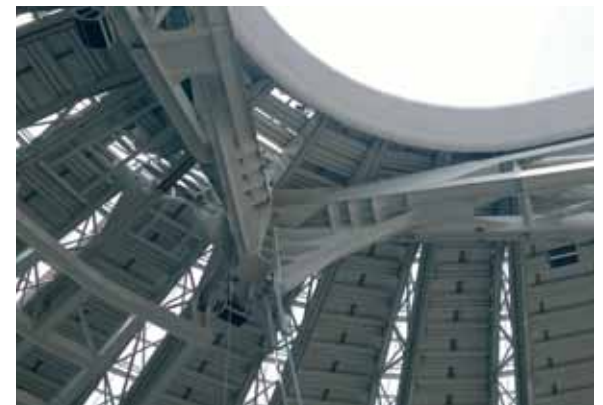
Fig. 8 - Particolare dell'attacco delle funi di appensione, di falda e di ritegno verticale in corrispondenza dei terminali delle travi principali
