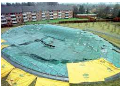
Figg. 106, 107 Esempio di collasso di una copertura reticolare monostrato dovuto a un fenomeno di instabilità di tipo snap through
