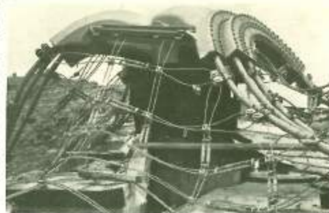
Fig. 7.36 Preparazione a terra della rete di funi relativa alla copertura del parco Olimpico di Monaco (7.15).
