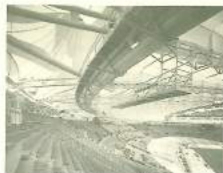
Fig. 8.90 Vista interna della copertura in corrispondenza dell'intradosso dell'anello reticolare. È possibile osservare i moduli pseudocorici interni all'anello, il sistema periferico di raccolta delle acque e la passerella di servizio interna.
